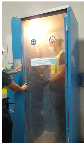
Fig. 6.1. Cabinas de limpieza de personal (Fuente: INS)
